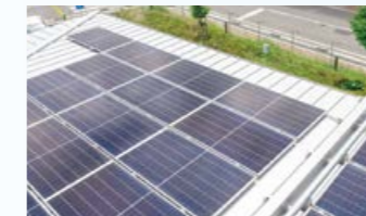
太陽光パネル
