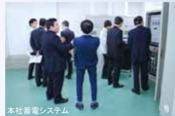
本社蓄電システム
