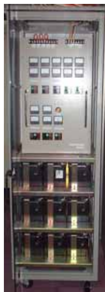
装置全体 (下部はバッテリー)
