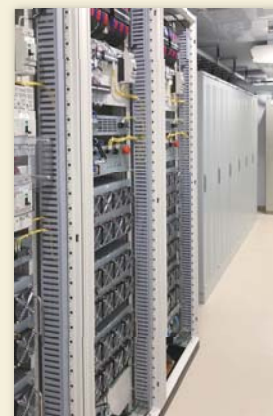
コンテナ内部設置イメージ
