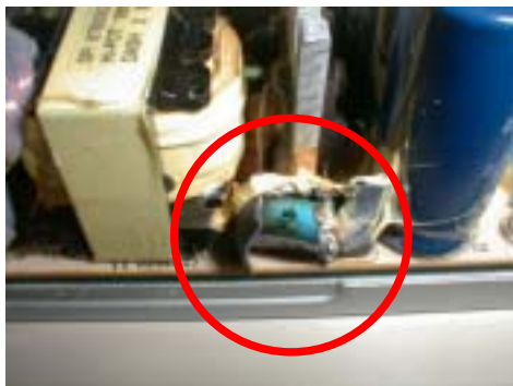
フィルムコンデンサ破裂 このとき高熱になるため発火の恐れあり
