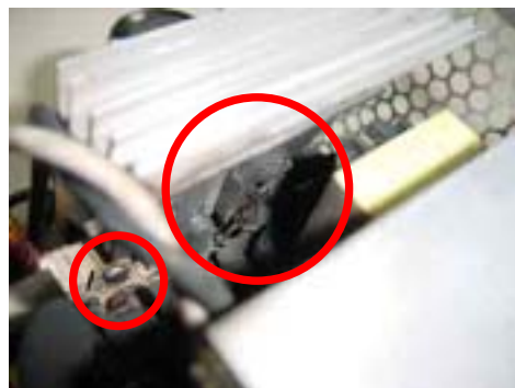
メインFETが焼損 2次破壊も発生
