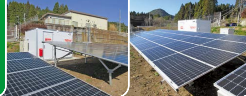
奥：蓄電池コンテナ
