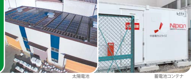
太陽電池 蓄電池コンテナ
