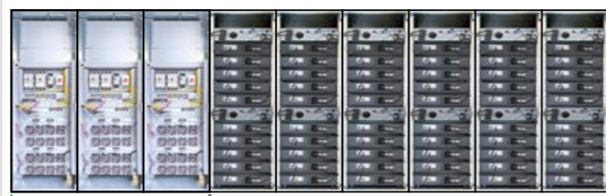
充放電コンバータラック 蓄電池ラック
